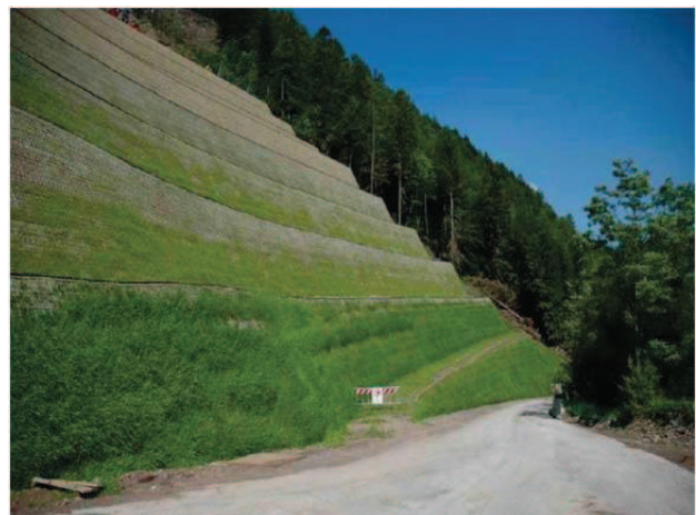
Figura 10. Face do talude, com crescimento da vegetação, durante o verão de 2005.
