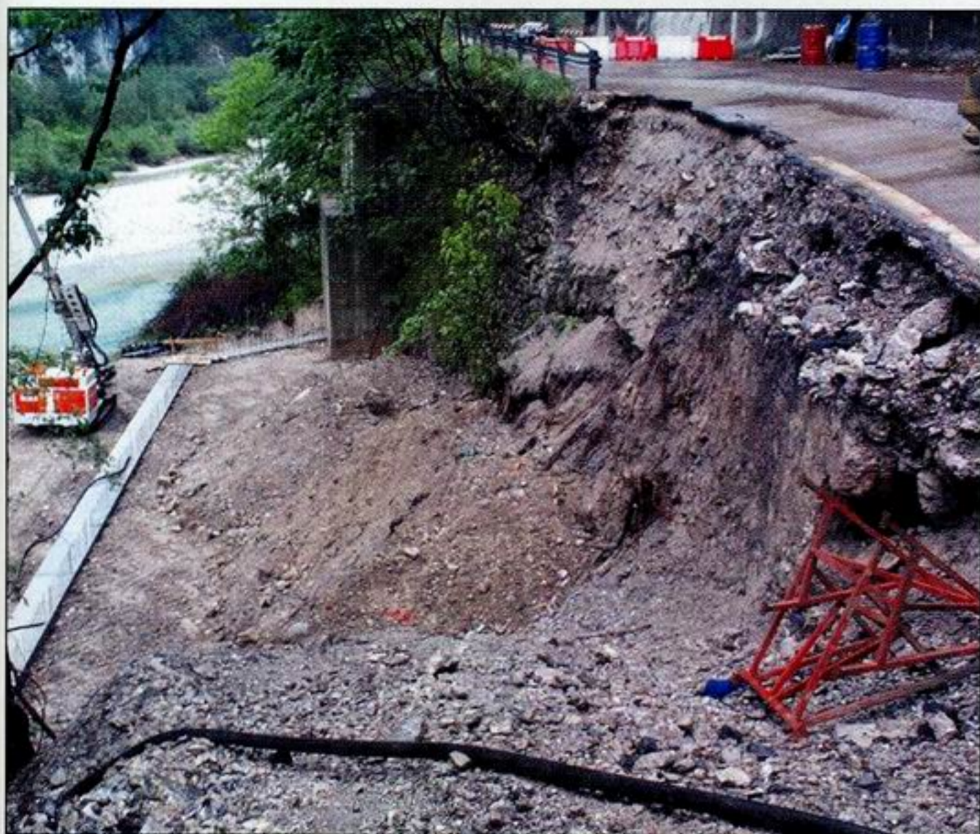
Il piano di imposta della terra rinforzata e la vista della frana
