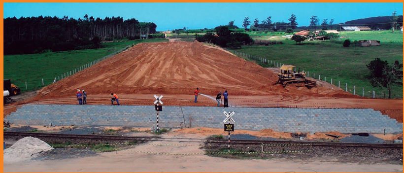
Figura 7. Vista geral da obra com a face do muro em primeiro plano.
